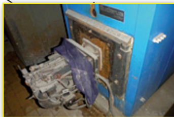
Joint de brûleur chaudière
