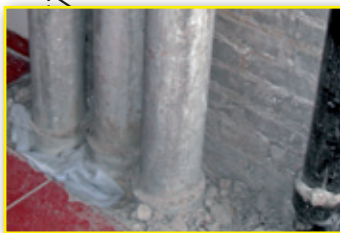
Tuyaux d'évacuation des eaux usées
