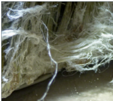
Amiante blanc (chrysotile)
